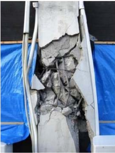
(a) 短柱のせん断破壊
