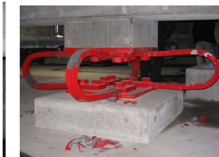
写真 5. 5. 1-16 U型鋼材ダンパーの塗料はがれ
