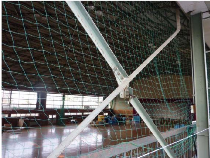
写真 5. 3-1 ブレース材の座屈と接合部破断
