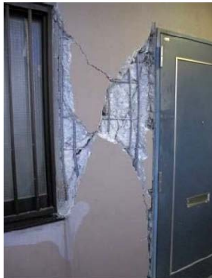
写真 5. 2. 1-12 非構造壁（玄関側）のせん断破壊
