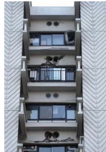
写真 5. 2. 1-8 境界梁 (開口付き) の損傷
