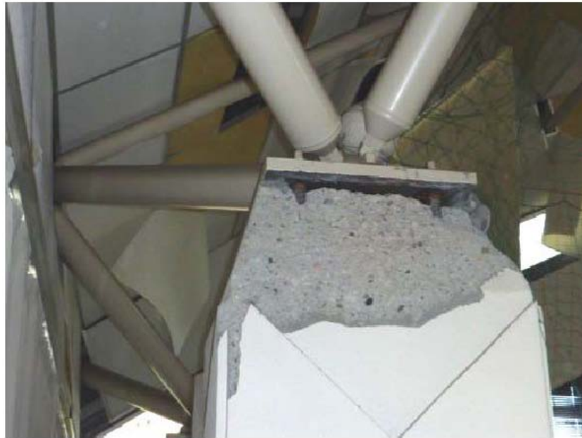
写真 5.3-11 RC柱とS造屋根接続部(支承部)のコンクリート剥落
