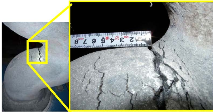
(b) 屈曲部のひび割れの状況
