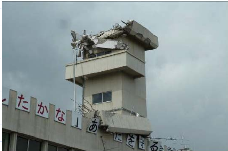
写真 5. 2. 1-4 塔屋の損傷及び落下
