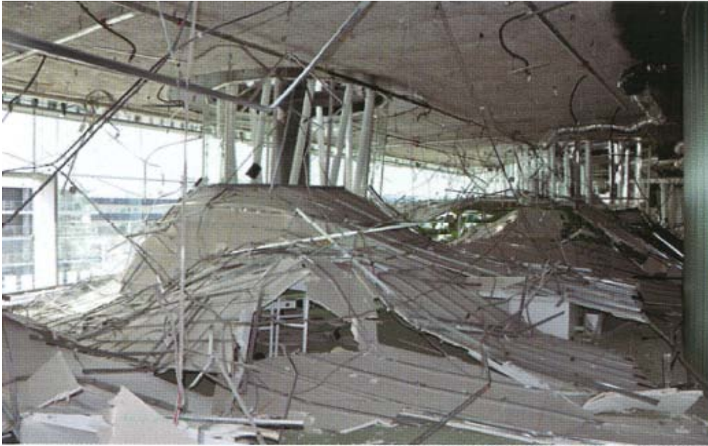
天井材の落下
