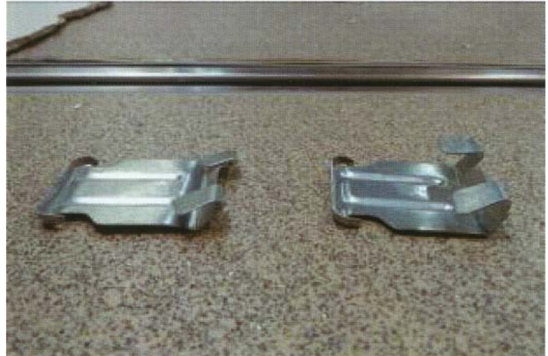
変形し脱落した天井下地クリップ
