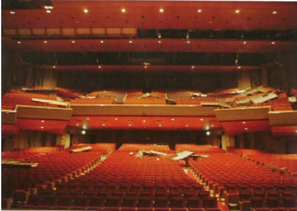
大ホール天井の落下(福島市)
