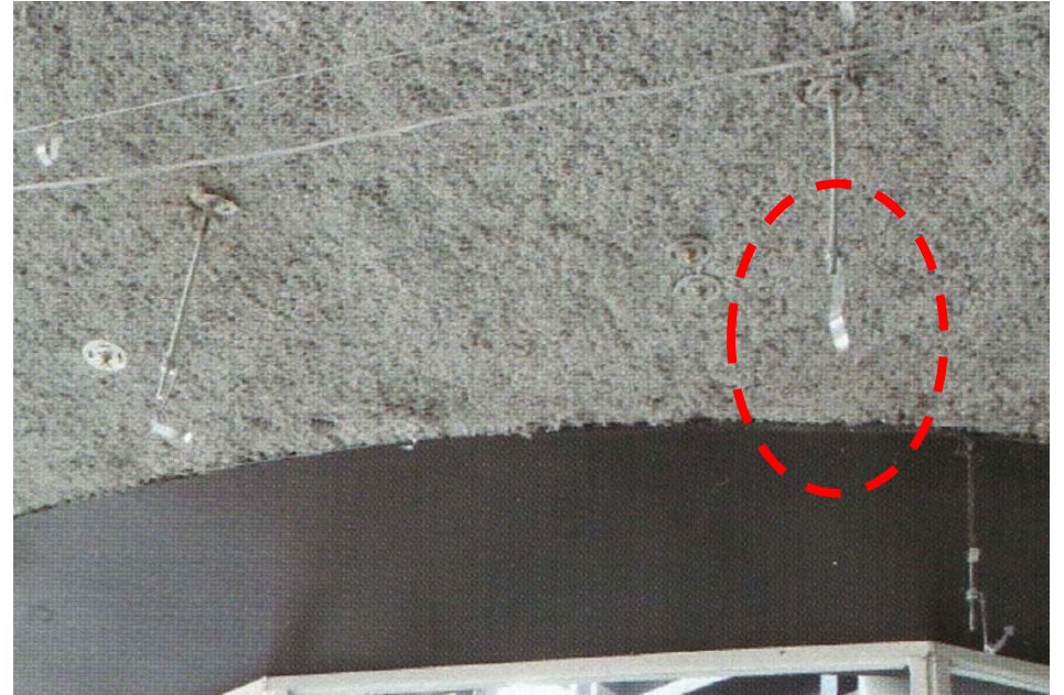
吊ボルト先端の野縁受けハンガーが開いた状態
