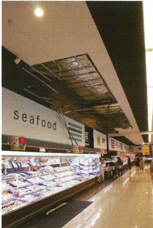
天井パネルの破損 (栃木県芳賀町)
