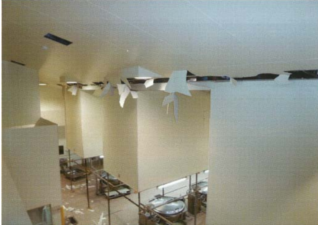
換気用フードと傾斜天井との接合面における損傷
