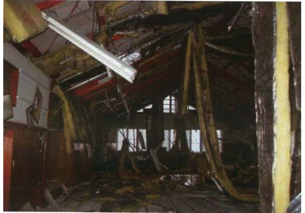
武道場天井の落下(仙台市)
