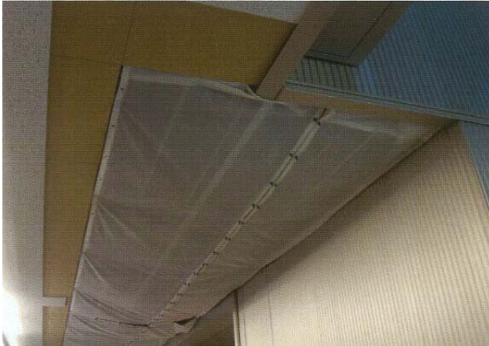
オフィスビル天井の落下(新宿区)
