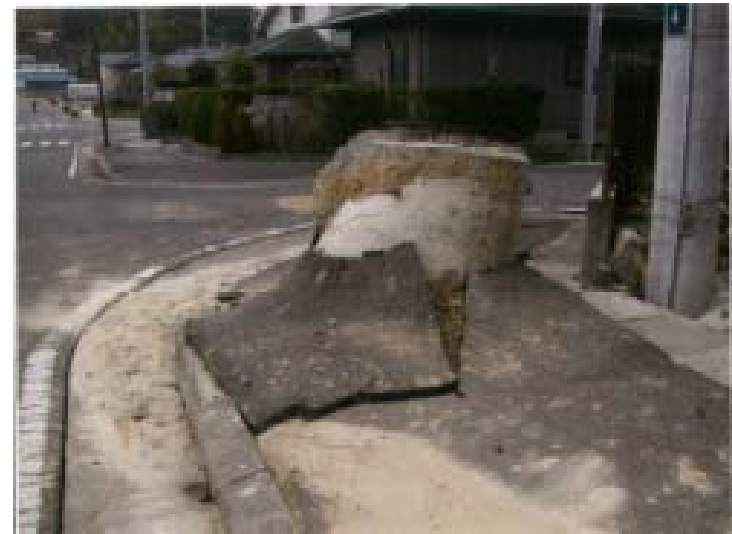
マンホールの浮上り 「2011年東北地方太平洋沖地震災害調査速報」 (日本建築学会)より
