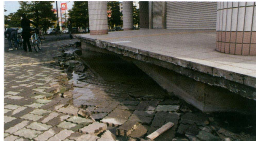
杭基礎周辺の地盤沈下(千葉県) 「2011年東北地方太平洋沖地震災害調査速報」(日本建築学会)より
