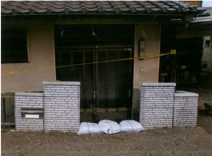
液状化による住宅の沈下(千葉県) 「2011年東北地方太平洋沖地震災害調査速報」(日本建築学会)より
