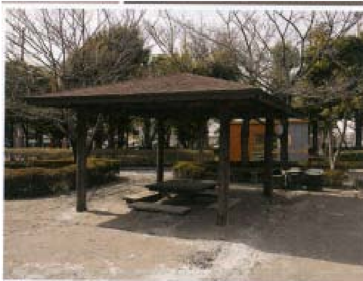
液状化による沈下した公園のあずまや 「覆る建築の常識」(日経アーキテクチャ編)より
