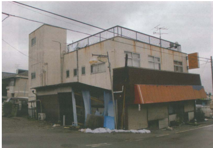
液状化による建物の傾斜(千葉県) 「2011年東北地方太平洋沖地震災害調査速報」(日本建築学会)より
