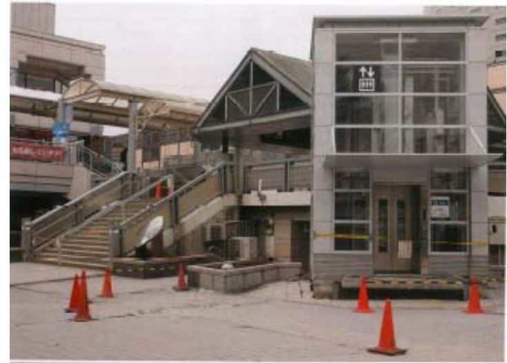
液状化による不同沈下(新浦安駅) 「覆る建築の常識」(日経アーキテクチャ編)より
