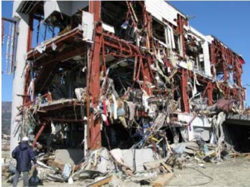
写真 6. 4. 2-15 残存する3階建てS造 (陸前高田市)
