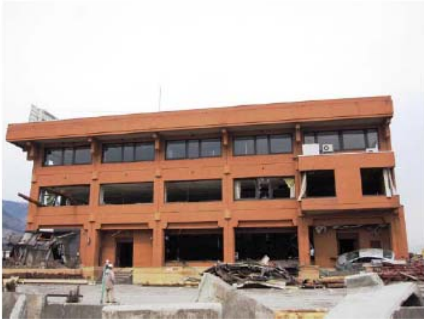
写真 6. 4. 1-13 衝突による非構造部材の損傷
