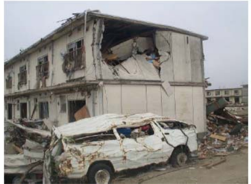
写真 6. 4. 1-14 漂流物の衝突による壁脱落
