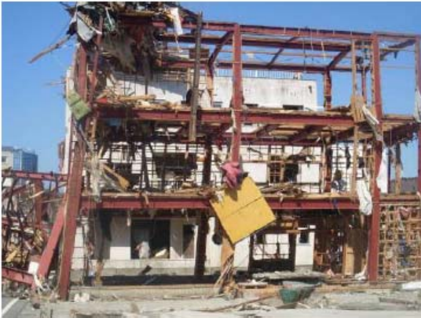
写真 6. 4. 2-12 傾斜した重層建築物（女川町）
