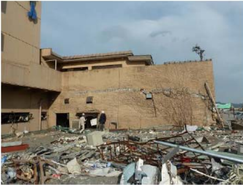
写真 6.4.1-11 非構造壁の面外破壊
