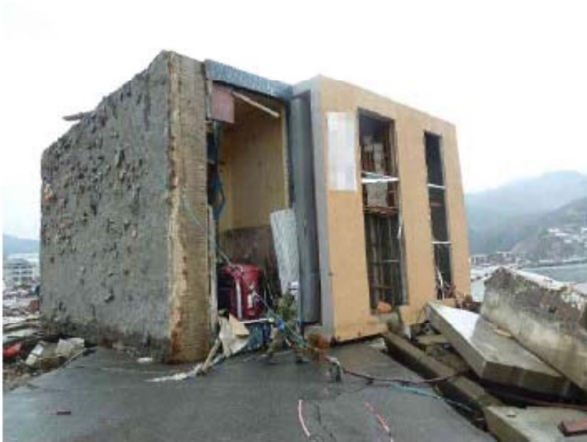
写真 6. 4. 1-3 3階建て建築物の転倒
