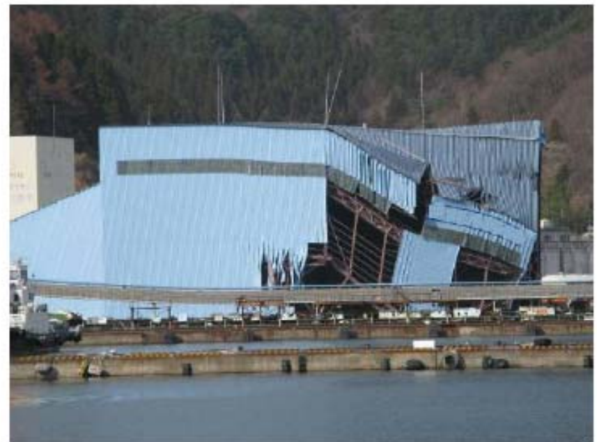
写真 6. 4. 2-11 部分的な崩壊（釜石市）
