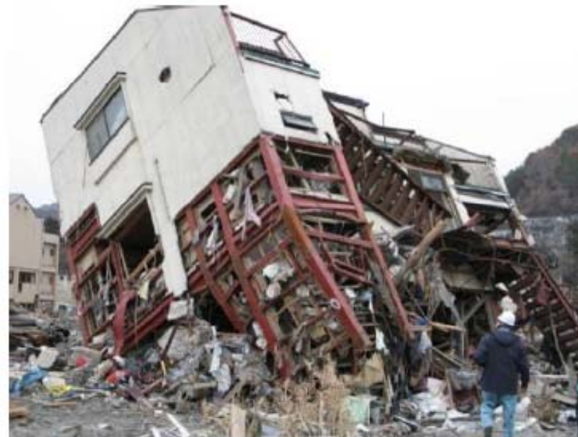
写真 6. 4. 2-9 3階建てS造の1階の崩壊（大槌町）
