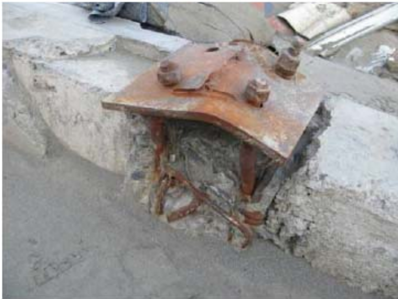
写真 6. 4. 2-1 柱脚部の破断（陸前高田市）
