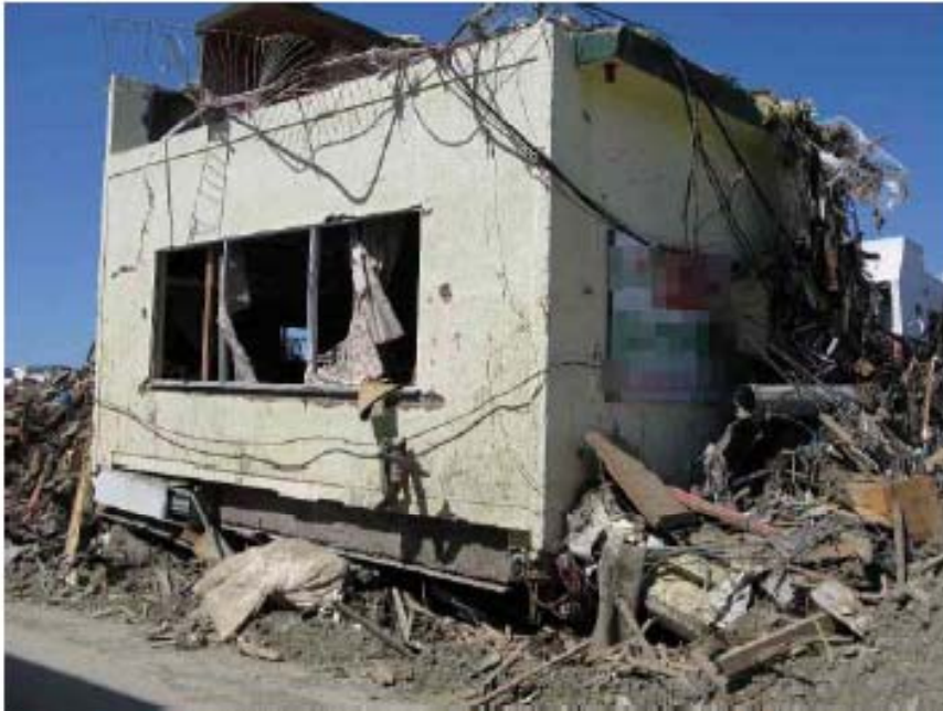
写真 6. 4. 1-1 2階建て建築物の層崩壊
