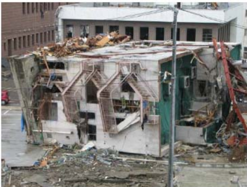
写真 6. 4. 2-8 3階建てS造の転倒（女川町）
