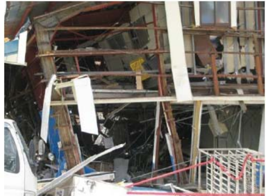
写真 6. 4. 2-14 傾斜した山形ラーメン架構 （海岸沿い、山田町）
