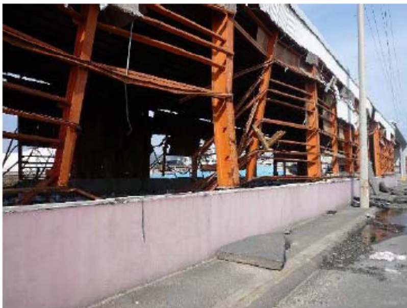
写真 6.4.2-25 柱の変形（石巻市）
