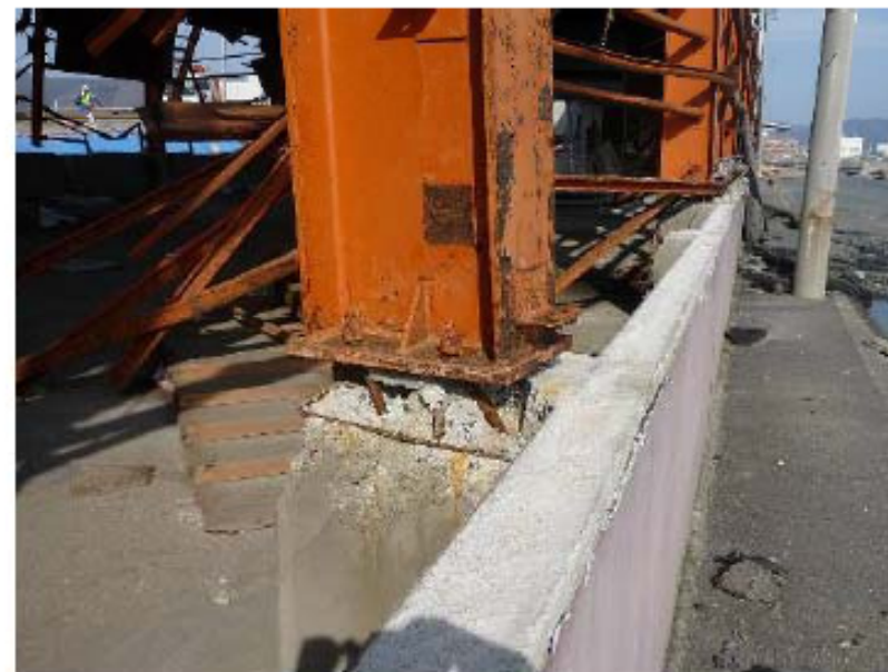
写真 6.4.2-26 柱脚部の移動（石巻市）
