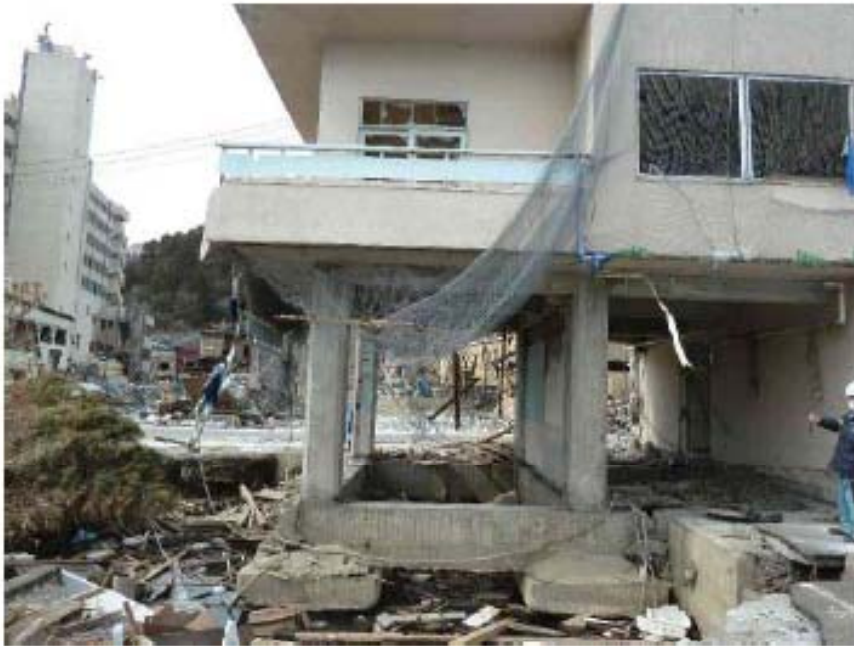
写真 6. 4. 1-9 洗掘による基礎露出
