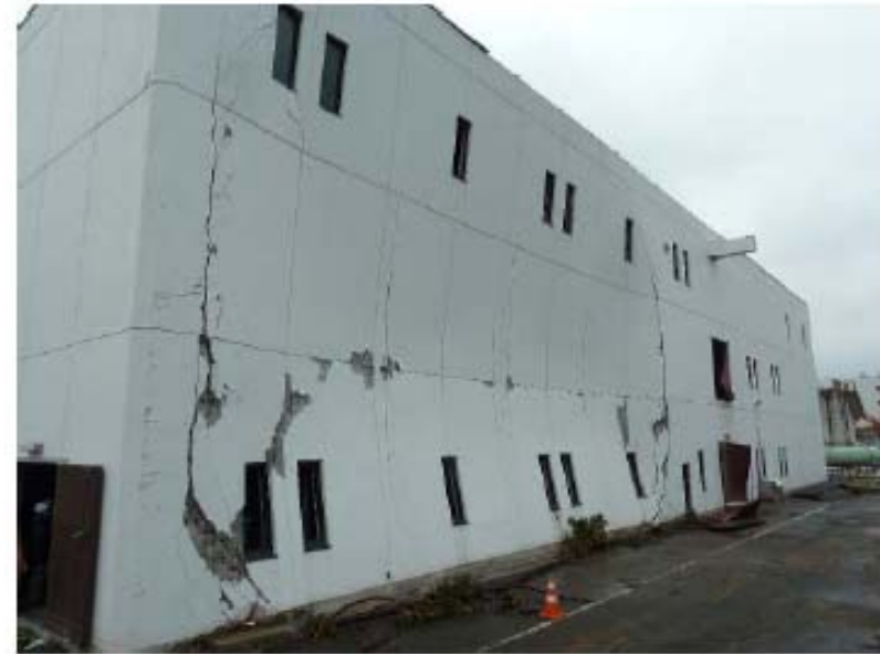
写真 6.4.1-12 床を持たない連層壁の面外破壊
