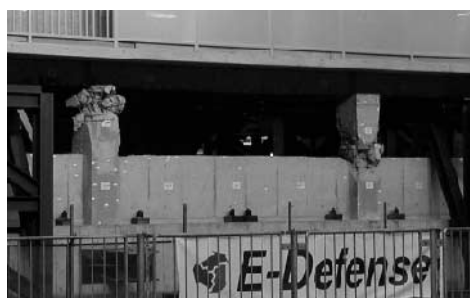
写真3 実験後のRC試験体
