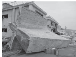
崩壊・転倒した防潮堤 (山田町、RC造)
