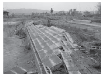
崩壊したブロック塀 (巨理町、CB造)
