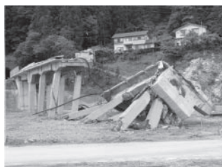
崩壊した鉄道橋 (田野畑村、RC造)
