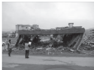
層崩壊した建築物 (陸前高田市、RC造、平屋)
