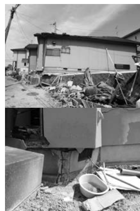
図3 地盤の滑り出しと布基礎の破壊
